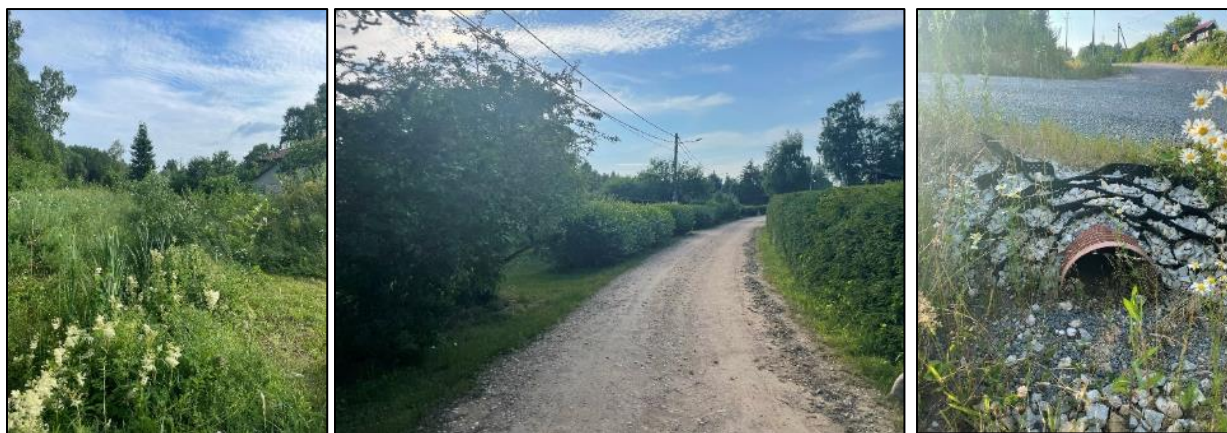
Pilt 13. Kaldaääre võsastunud kraav, puuduv kraavitus Kaldaääre tn, Kallaste ristmiku pooleldi ummistunud truubid.
